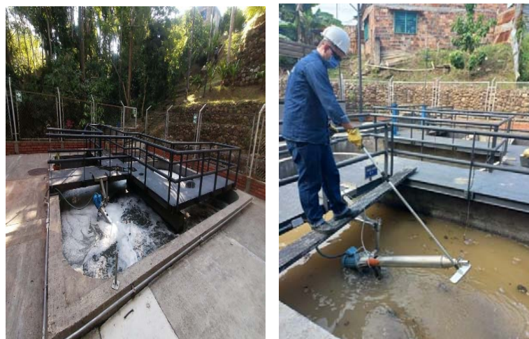
Adecuación de la Miniptar del Distrito De Barrancabermeja
